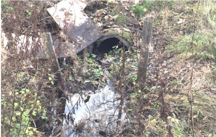
Figur 5.12 Utlopp av dagvattenledning, tidigare provtagningspunkt 22.
