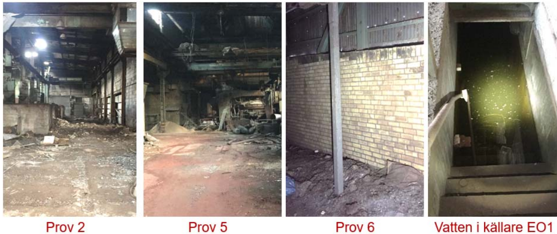
Figur 5.10 Bilder från byggnader där prov tagits på stoft på mark samt även bild på vattenfylld källare. Vattnet är inte provtaget.
